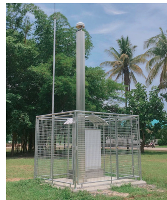
タイの電子基準点。衛星の電波を受信するアンテナ、受信機、通信機器が格納されている。
